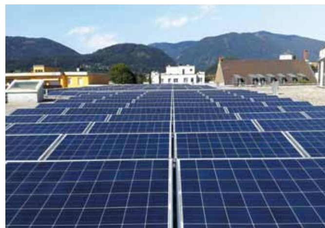
Wie das Möbelhaus Rutar nutzen bereits zahlreiche Unternehmen ihre Dachfläche für ein Sonnenkraftwerk von „Unser Kraftwerk“
