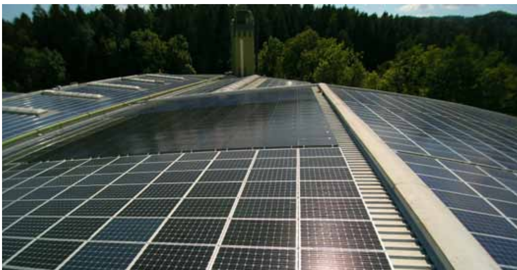
In Wernersdorf (Bild) und Neudau entstehen neue Sonnenkraftwerke
